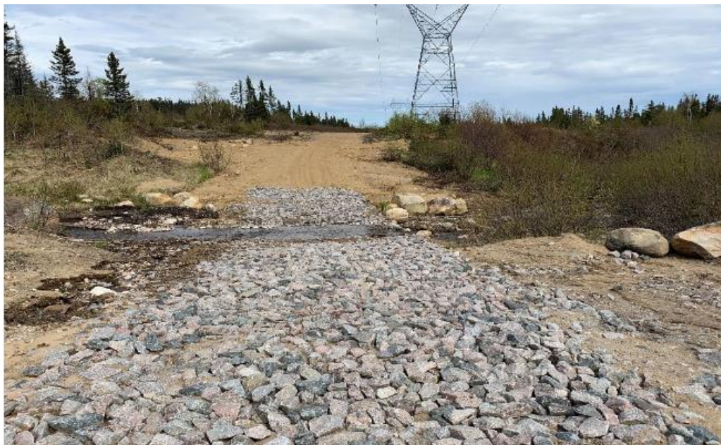
Stabilisation d'un passage à gué (Méthode de conception de traverses à gué aménagées/ © Vicky Larocque, 2020)
